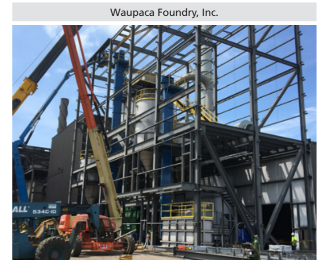
Plant5に導入した砂再生処理装置
