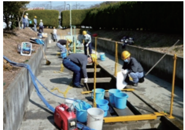
工場内水路へ流出した重油を回収(豊浦工場)
