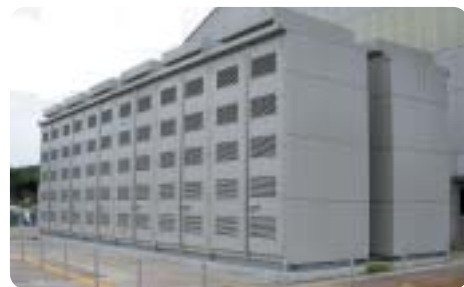
蓄電池システム
