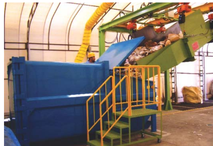
土浦工場の紙屑圧縮装置
