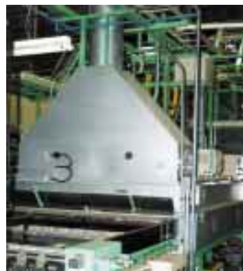
溶剤ガス分解装置
