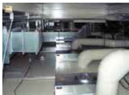
天井裏フィルタユニット
