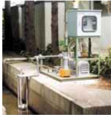
水質監視システム
