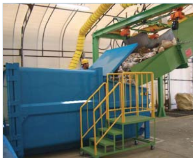
土浦工場の紙屑圧縮装置
